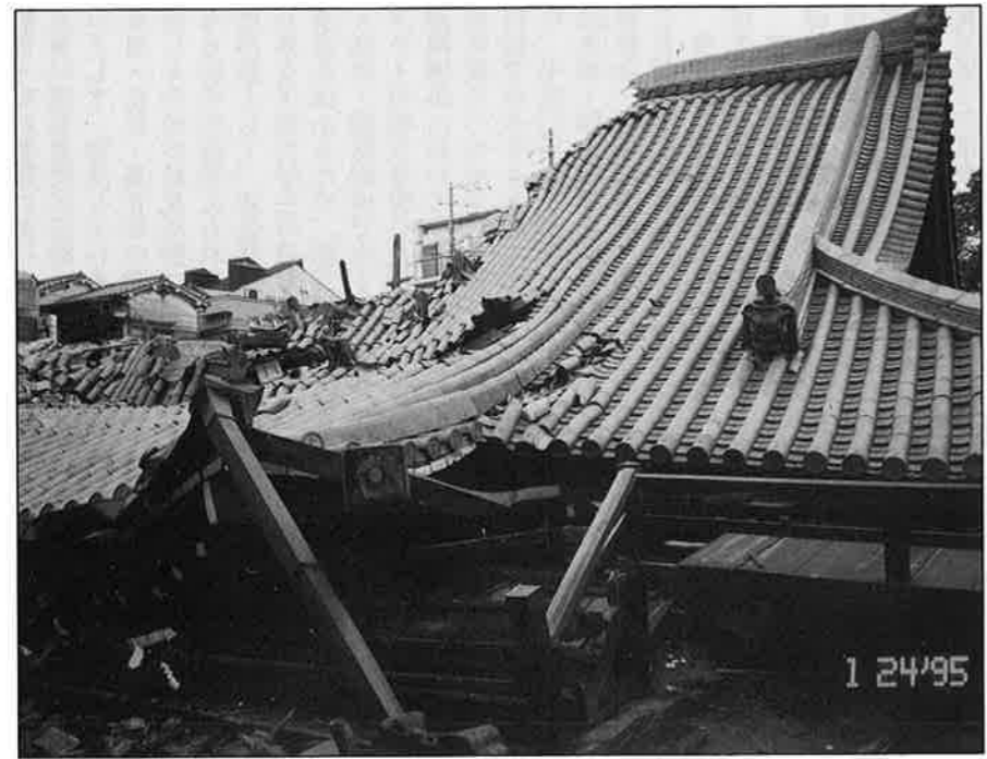
本堂屋根の一部を残しすべて倒壊した神戸東組覚浄寺
