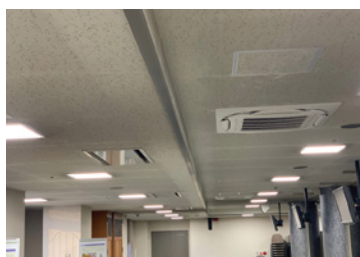
天井に設置された空調（本堂）
