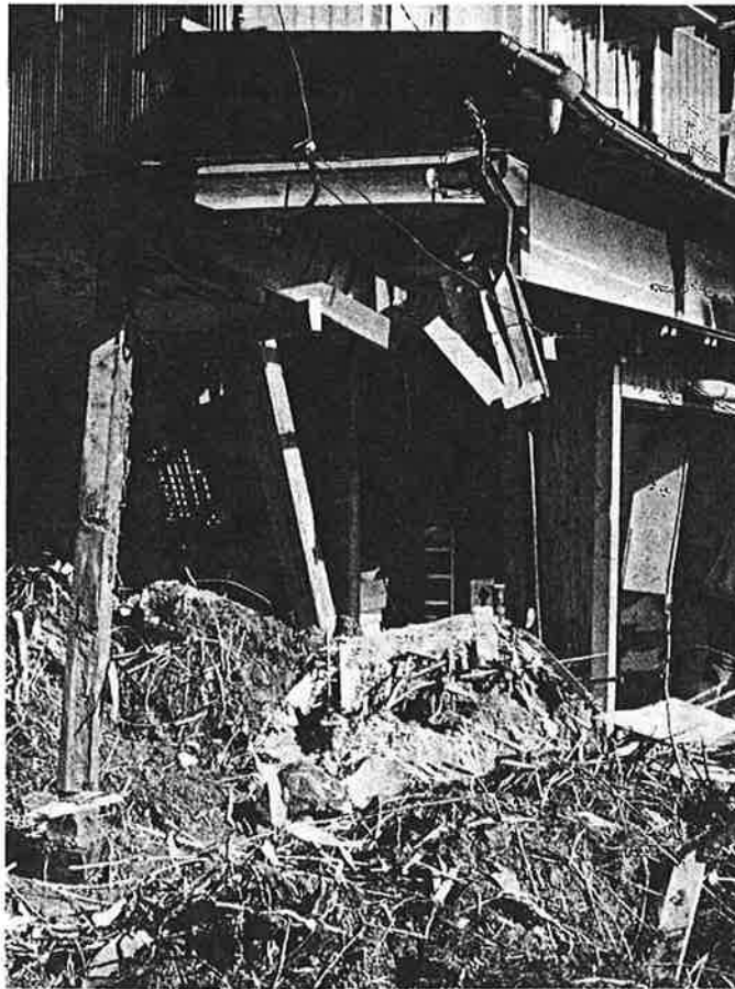
土砂で西光寺庫裡の玄関、炊事場が崩壊
