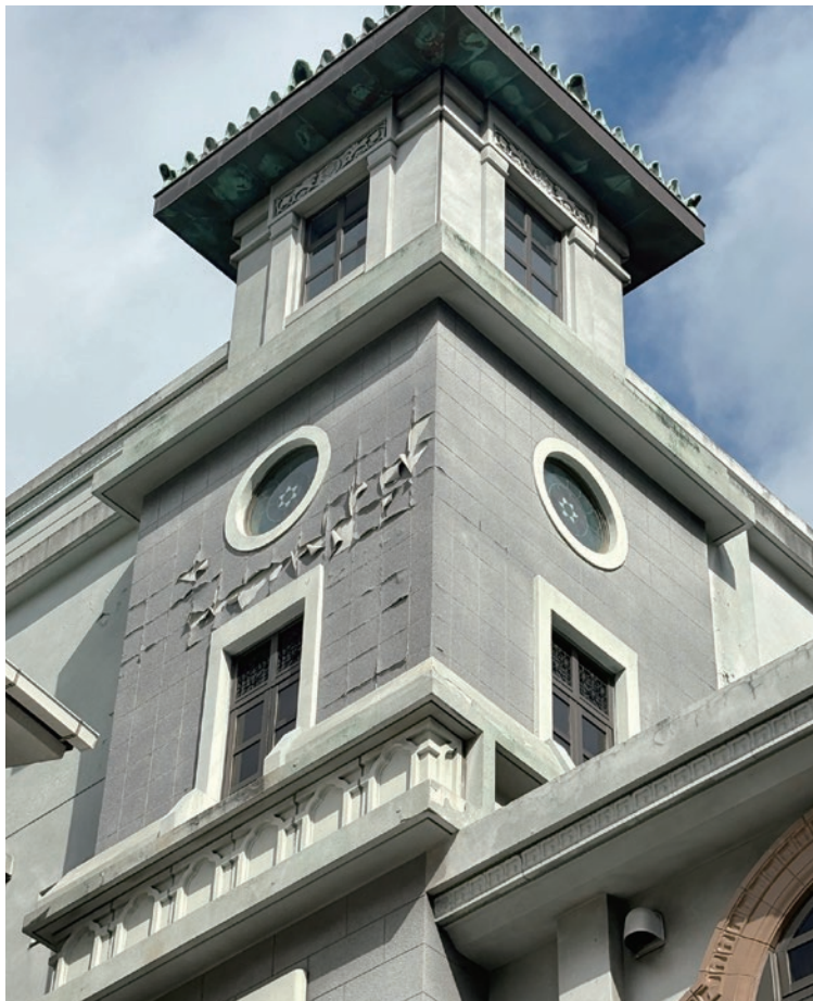
特に傷みが激しい西側外壁
